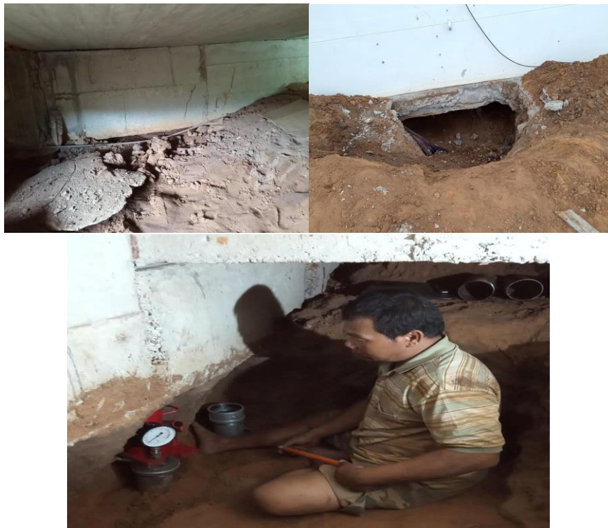
ภาพที่ 1 เส้าและโครงสร้างอาคารที่เกิดการกัดกร่อน
